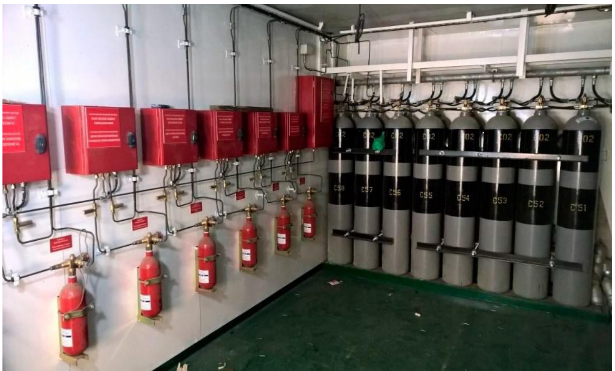
Мал.5. Станція вуглекислотного гасіння пожеж в МО і вантажних трюмах.
